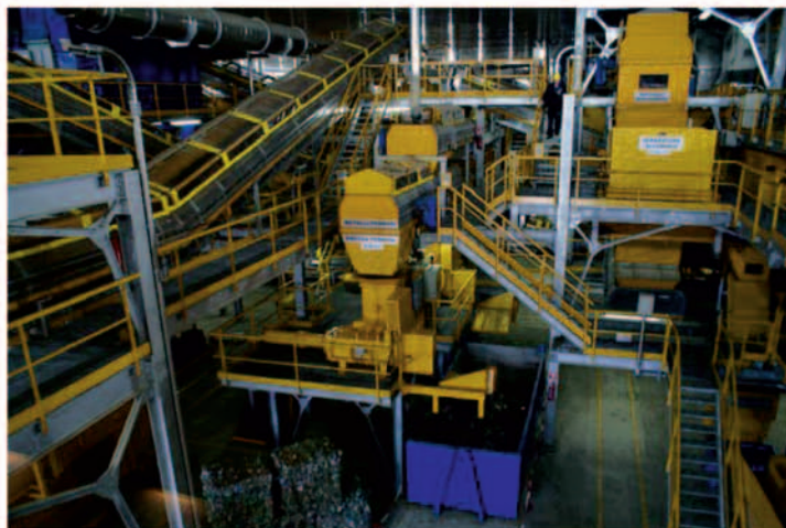
▲ Impianto TMB, sezione di recupero materiali - Roma -
