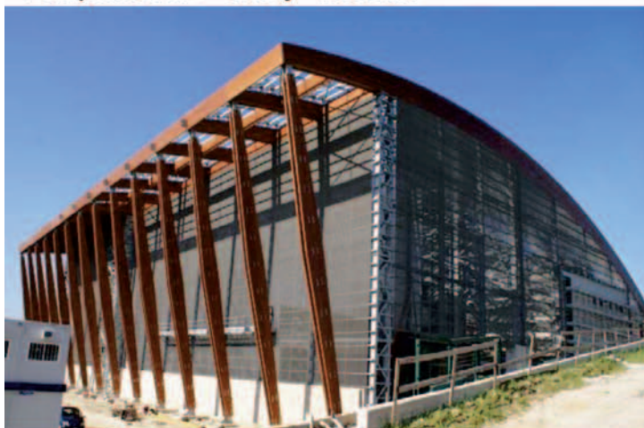
▲ Centrale di Gassificazione CDR - Roma - Italia
