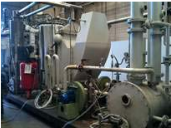
Foto2: Un impianto di gassificazione biomasse legnose
